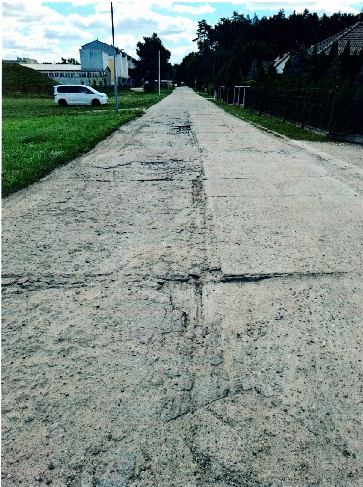
Fot. 2. Widok odcinka ulicy Gajowej – widoczne liczne nierówności, spękania i ubytki nawierzchni.
